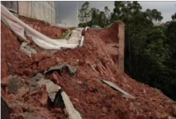
Figura 6. Vista geral do trecho rompido.
