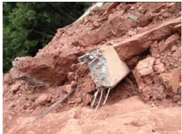
Figura 4. Seção da viga de ancoragem rompida.
