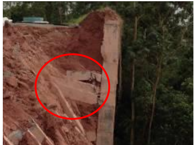
Figura 2. Seção da contenção rompida (Notar vigas de ancoragem a montante do paramento).
